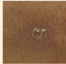
6. Kısmen dökülmüş kabuk
